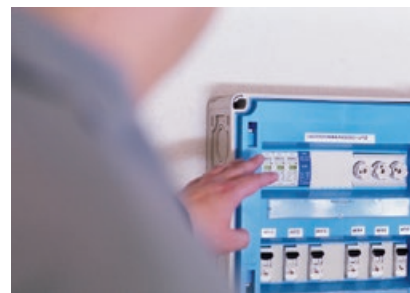
Ochrona przeciwprzebieciowa rozdzielnic AC w systemie fotowoltaicznym
