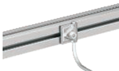
Wyrównanie potencjałów instalacji fotowoltaicznej
