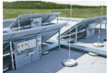
Izolowana ochrona odgromowa oraz ograniczniki kombinowane do ochrony falownika
