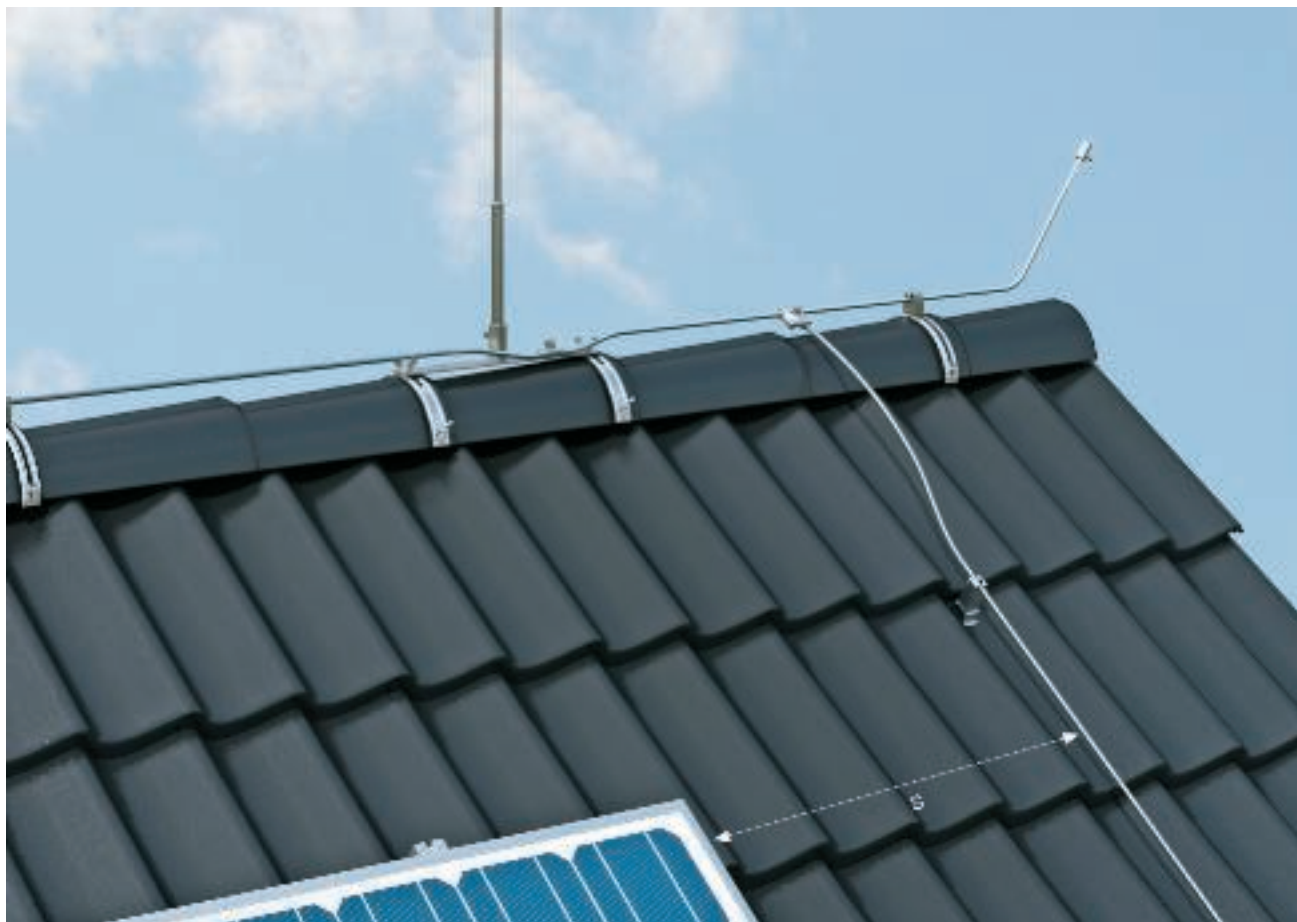
Dach pochyły z instalacją fotowoltaiczną oraz ochroną odgromową
