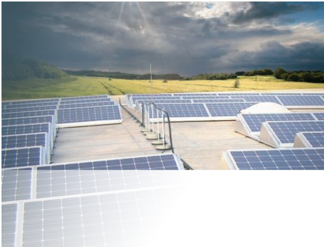
Dach płaski z systemem fotowoltaicznym oraz izolowanym kablem isCon®
